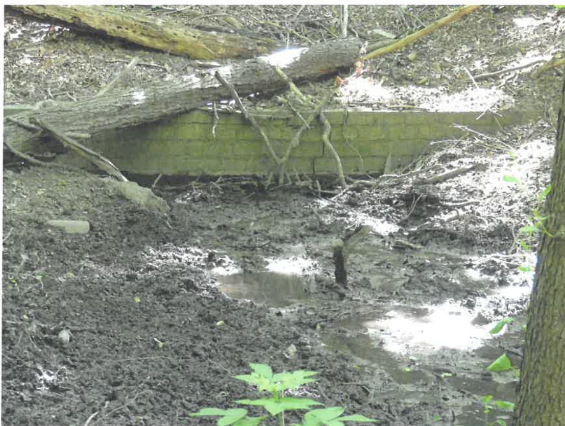
Fot. 5. Zamulony przepust poniżej osuwiska.
