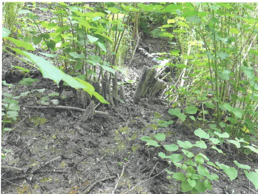
Fot. 2. Zniszczone umocnienia skarpy na jęzorze osuwiska.
